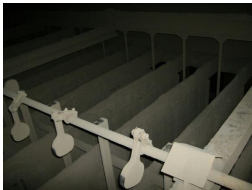
Slika A-4. Unutrašnjost elektrostatskog filtra TE Plomin 2 (u prvom planu uređaj za mehaničko otresanje kolektorskih elektroda).
